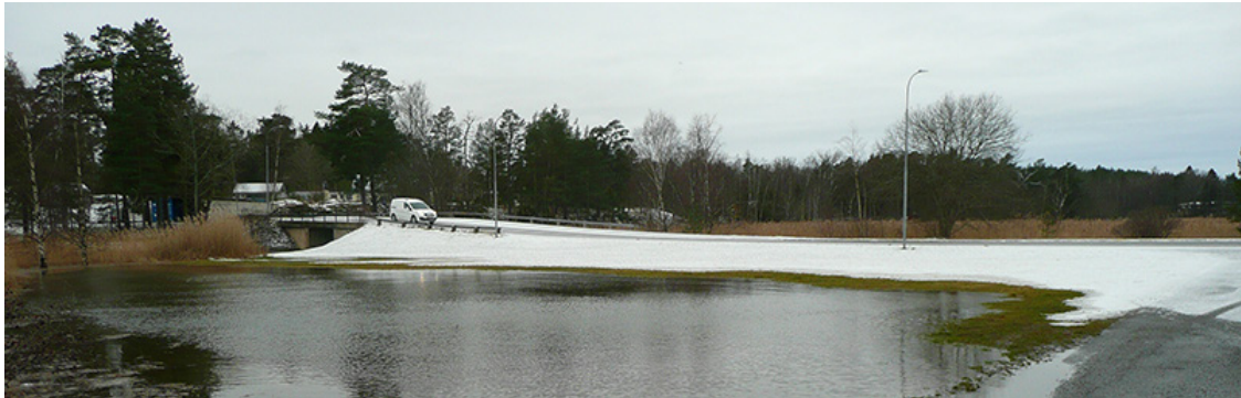
Jagersöbron förbinder ön med fastlandet. Körbanans ovansida är +3,1 meter RH2000. Bilden är tagen kl 08:40 under högvattnet den 26 februari 2020. Uppmätt havsvattenstånd vid Vinterklasen var vid tidpunkten +90 cm.
